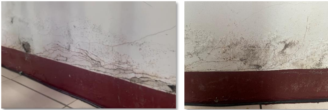
老宅外牆牆基部分龜裂現況
